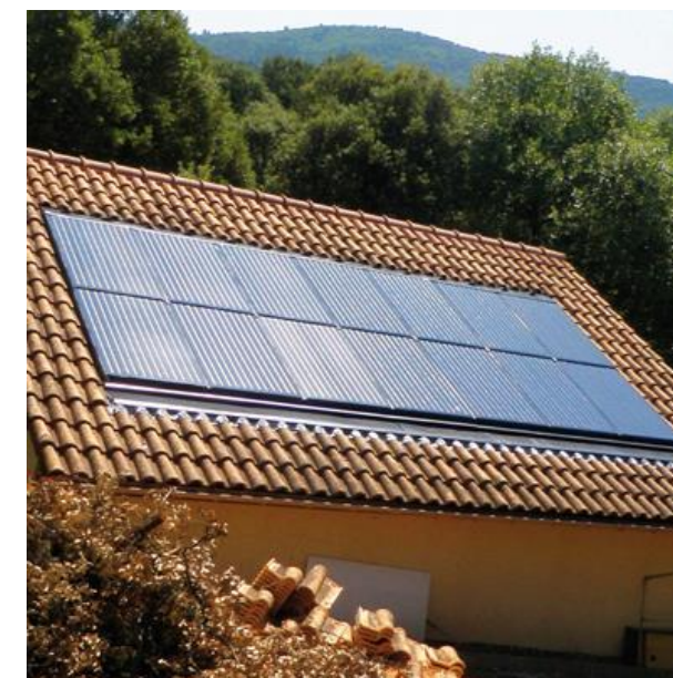
☞ Photographie 2 : Panneaux photovoltaïque intégrés en toiture
