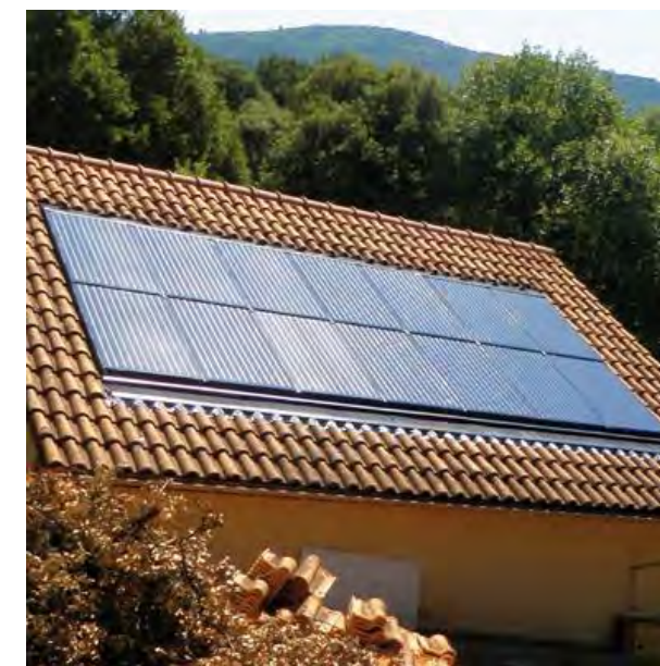
☞ Photographie 2 : Panneaux photovoltaïque intégrés en toiture
