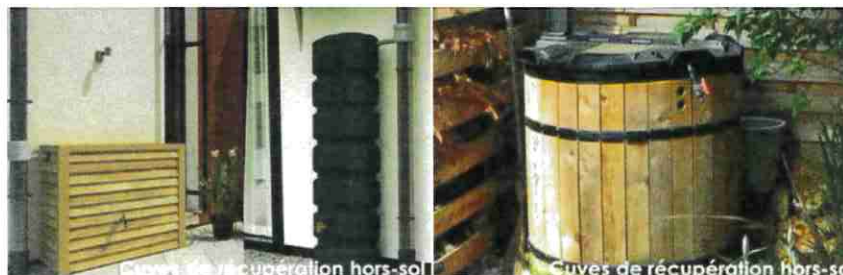
Cuves de récupération hors-sol positionnées sur la descente de gouttière
