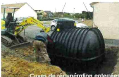
Cuves de récupération enterrées
